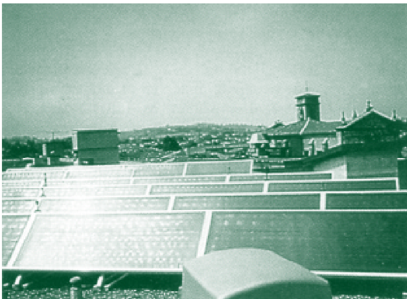
Batteria di collettori solari sul tetto di un ospedale
