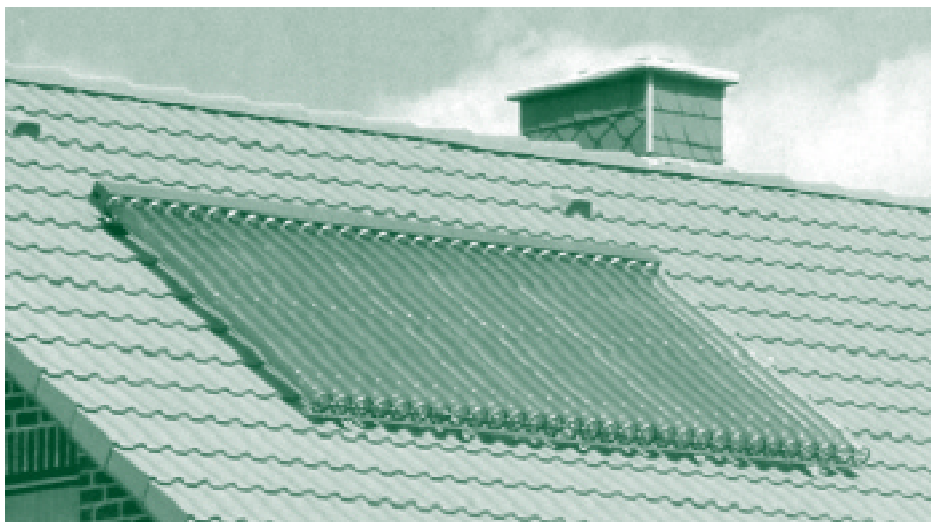
Pannelli solari sottovuoto installati sul tetto
