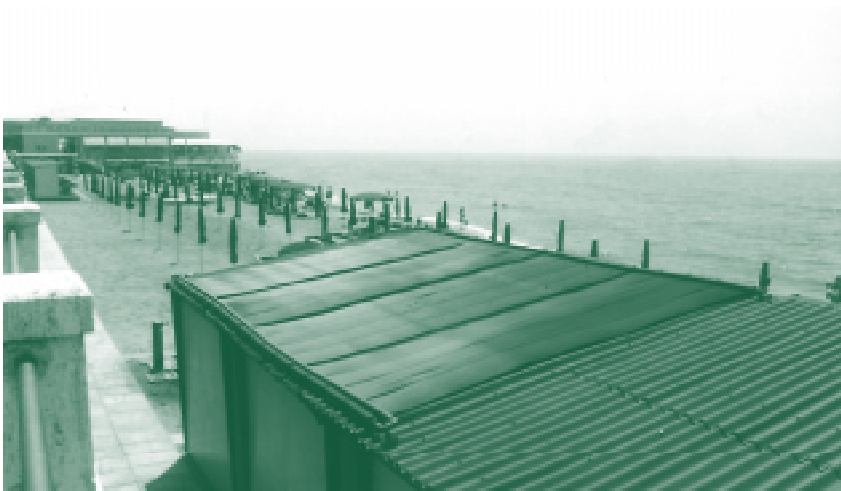
Docce libere da spiaggia riscaldate con pannelli senza serbatoio
