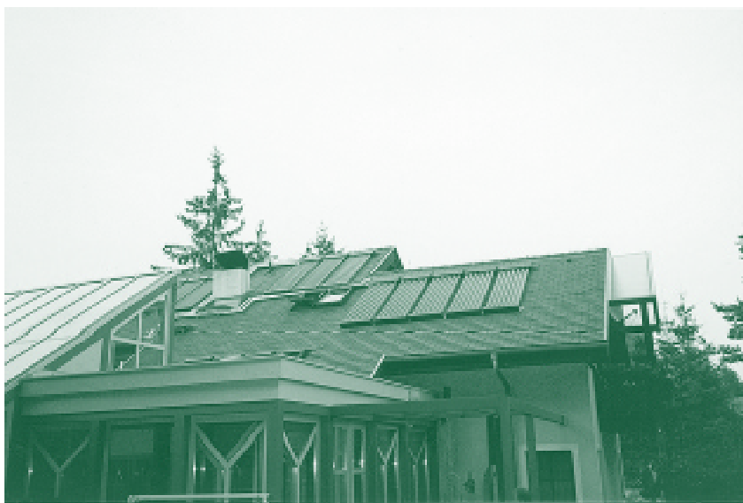
Pannelli solari installati sul tetto di una villa
