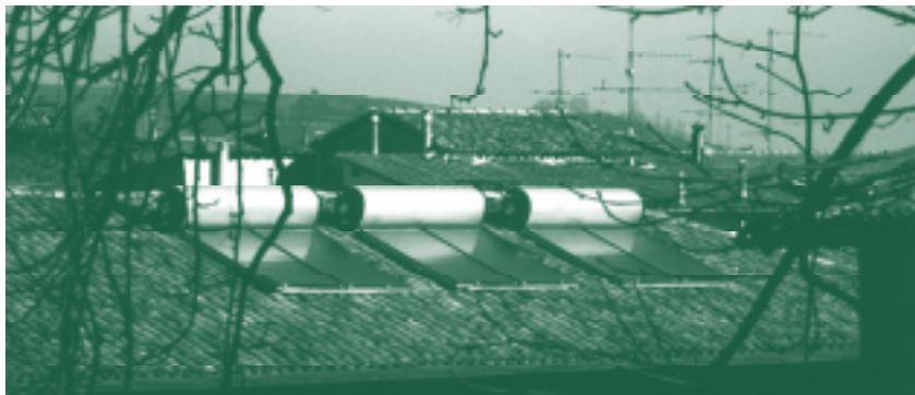
Pannelli solari installati su un tetto a tegole
