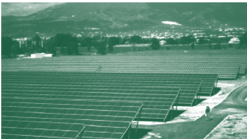
Centrale fotovoltaica ENEL di Serre
